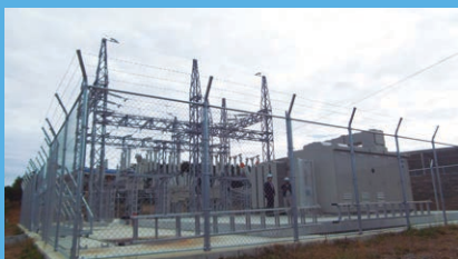
太陽光発電所
